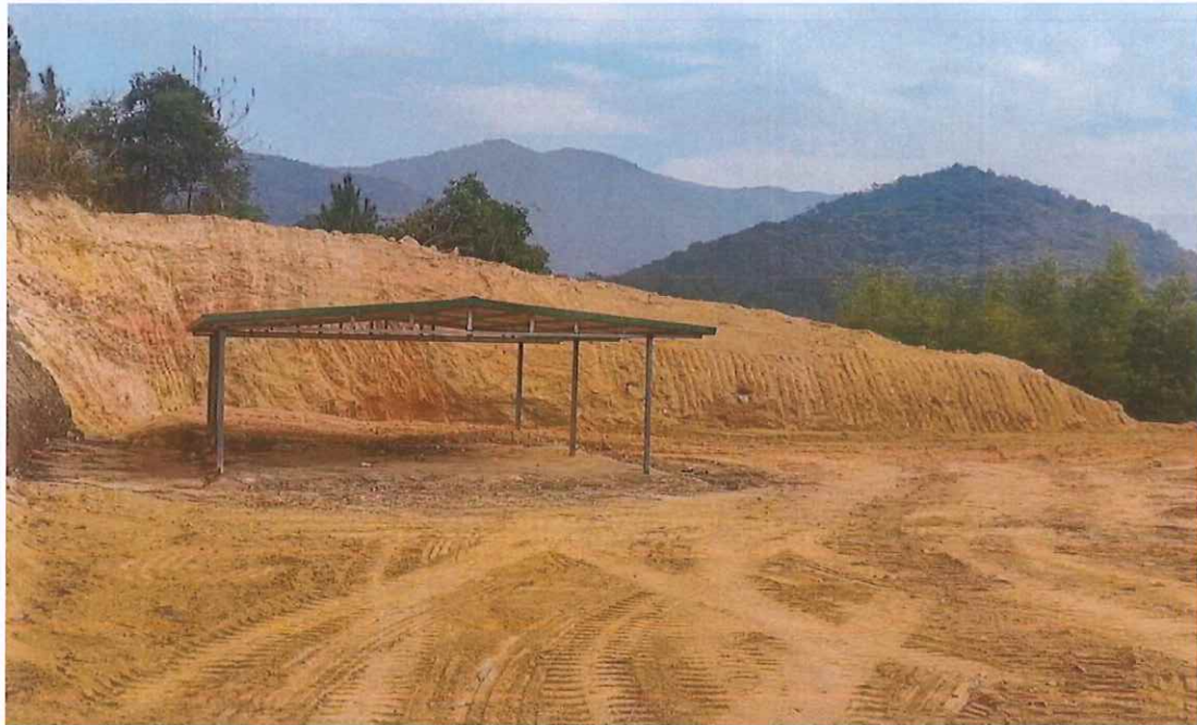
附图 1：散滩水库水利工程管理范围内修建构筑物。
