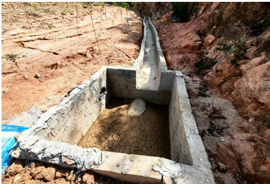
图4-2 露天采场修建的排水沟现场照片
